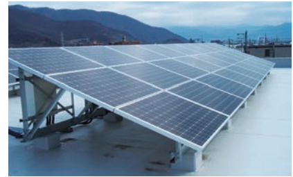
新朝気支店の太陽光発電システム
